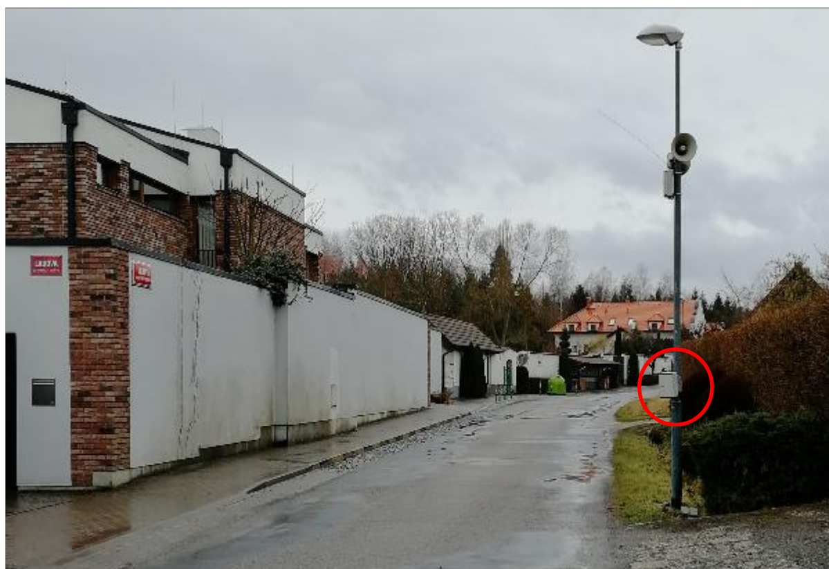
Obr. 4: Fotografie instalace radaru
