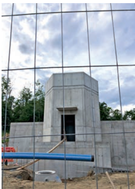
Vodojem na Žebrově, nutná podmínka pro budoucí vodovod pro Borovou Lhotu
